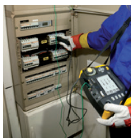
Mantenimiento terciario e industrial, diagnósticos y controles
