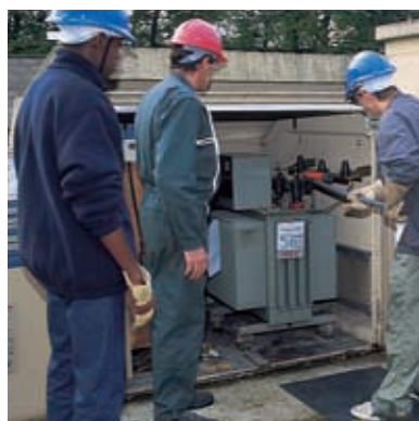
Mesures sur un transformateur en tête de ligne
