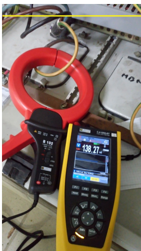
Messung mit Leckstromzange und Fehleraufzeichnung.
