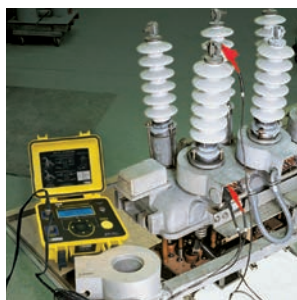
Misura del rapporto di un trasfor- matore di corrente
