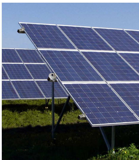
Exemple de positionnement du pyranomètre
