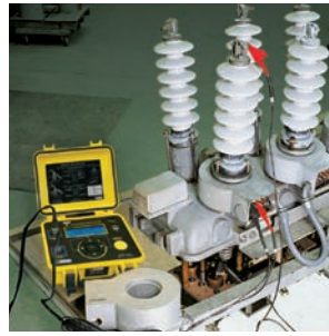
Messung des Wandlerverhältnisses an einem Stromwandler
