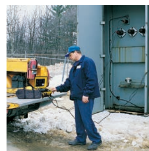
Mesure sur transformateur triphasé 2000 kVA en extérieur
