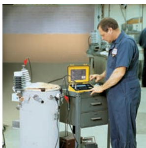
Mesure sur un transformateur en atelier
