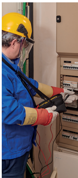
การควบคุมตู้ไฟฟ้า
