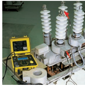
Medida de la relación de un transformador de corriente
